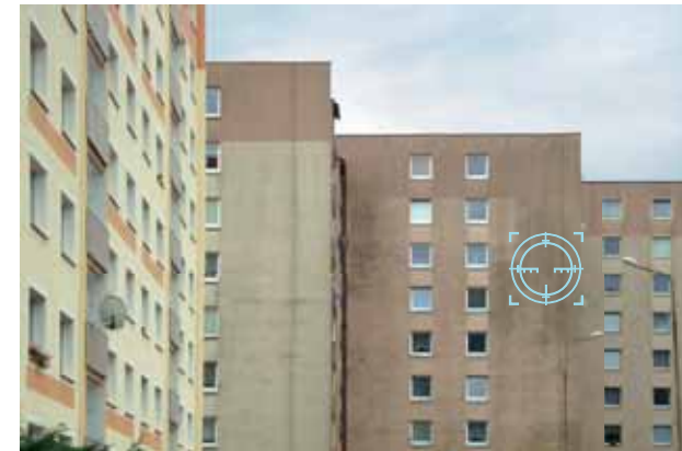
Niezabezpieczony tynk z zanieczyszczeniami biologicznymi.
